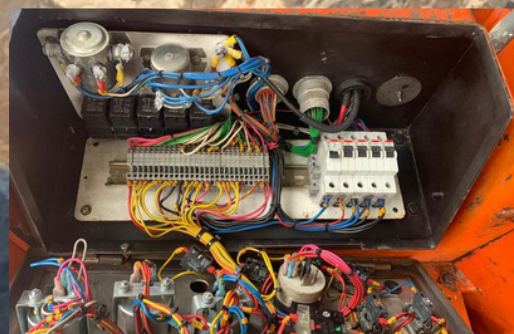
MANTENIMIENTO DE SISTEMA ELÉCTRICO
